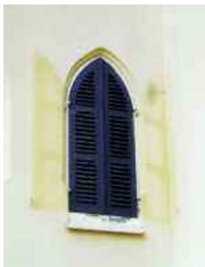
Die Bilder zeigen im Bereich der Fensterläden und Dachüberstände deutlich sichtbare Farbtonveränderungen
